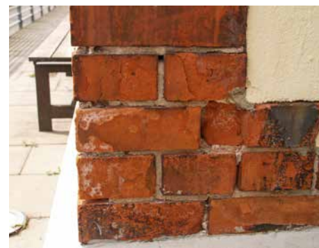
Salz und Feuchtigkeit sind hartnäckige Feinde historischer Bausubstanz
